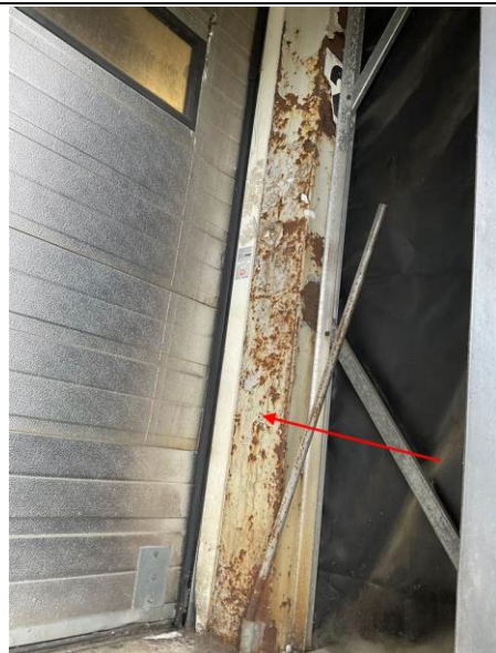
Photo n° PhPb004 Localisation : Extérieur UD : encadrement porte de quai (mesure 1) Type de dégradation : NC - Substrat : Métal - Revêtement : Peinture blanche - Mesure : 0,81
