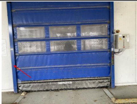
Photo n° PhPb021 Localisation : Quai d expedition UD : embrasure porte de quai (mesure 1) Type de dégradation : NC - Substrat : Métal - Revêtement : Peinture bleue - Mesure : 0,63
