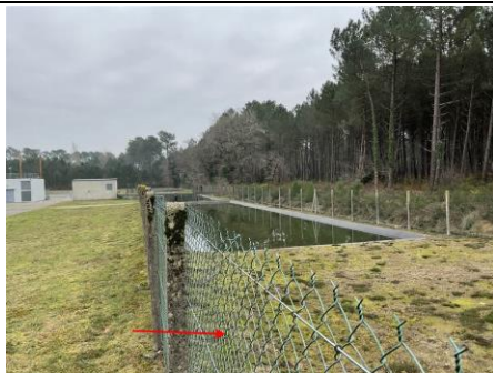
Photo n° PhPb022 Localisation : Extérieur UD : cloture (mesure 1) Type de dégradation : NC - Substrat : Métal - Revêtement : Peinture verte - Mesure : 0,33
