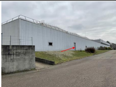
Photo n° PhPb023 Localisation : Couloir et salle de charge UD : porte ouest Type de dégradation : NC - Substrat : Métal - Revêtement : Peinture grise - Mesure : 5,32
