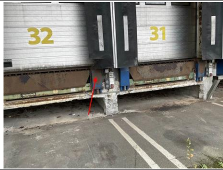
Photo n° PhPb006 Localisation : Extérieur UD : stop camions Type de dégradation : NC - Substrat : métal - Revêtement : Peinture bleue - Mesure : 0,54
