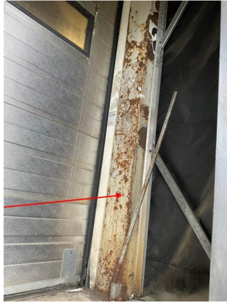
Photo n° PhPb007 Localisation : Extérieur UD : encadrement porte de quai Type de dégradation : NC - Substrat : Métal - Revêtement : Peinture blanche - Mesure : 0,81
