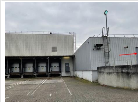
Photo n° PhPb025 Localisation : Couloir et salle de charge UD : porte nord Type de dégradation : NC - Substrat : Métal - Revêtement : Peinture grise - Mesure : 3,47
