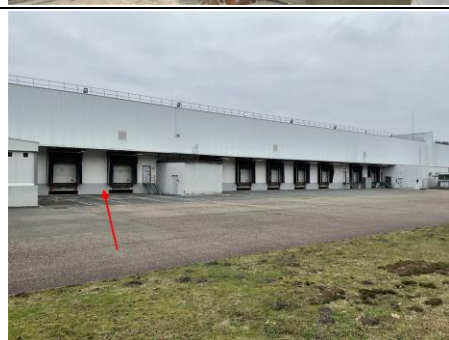
Photo n° PhPb005 Localisation : Extérieur UD : soubassement (mesure 1) Type de dégradation : NC - Substrat : béton - Revêtement : Peinture grise - Mesure : 0,58
