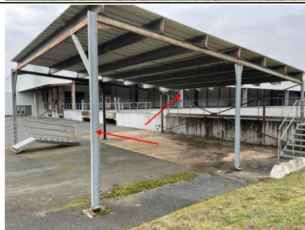
Photo n° PhPb009 Localisation : Extérieur UD : structure auvent (mesure 1) Type de dégradation : NC - Substrat : Métal - Revêtement : Peinture grise - Mesure : 0,33
