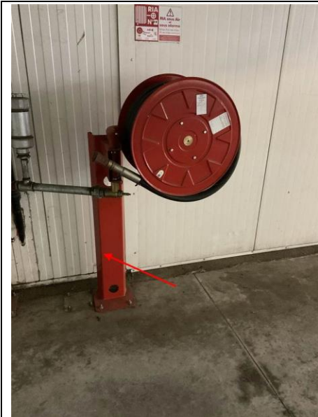
Photo n° PhPb019 Localisation : Quai d expedition UD : RIA (mesure 2) Type de dégradation : NC - Substrat : Métal - Revêtement : Peinture rouge - Mesure : 0,72
