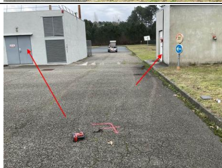
Photo n° PhPb010 Localisation : Extérieur UD : portes locaux techniques (partie basse) Type de dégradation : NC - Substrat : métal - Revêtement : peinture grise - Mesure : 0,79
