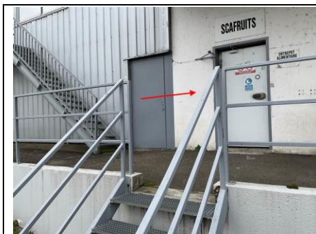
Photo n° PhPb001 Localisation : Extérieur UD : Facades (mesure 1) Type de dégradation : NC - Substrat : béton - Revêtement : peinture blanche - Mesure : 0,75
